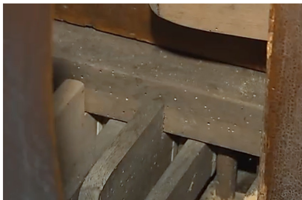
Poškození od červotoče
